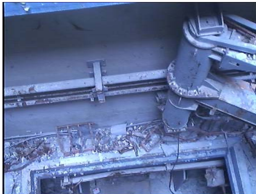
④ 2F西側外壁及びび床上状況
