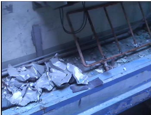
⑧ 3F西側外壁脚部及びび床上状況
