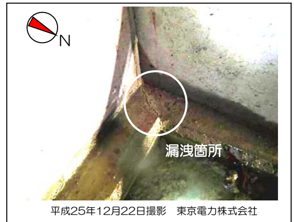
【G6北タンクエリア北側堰のヒビ】
