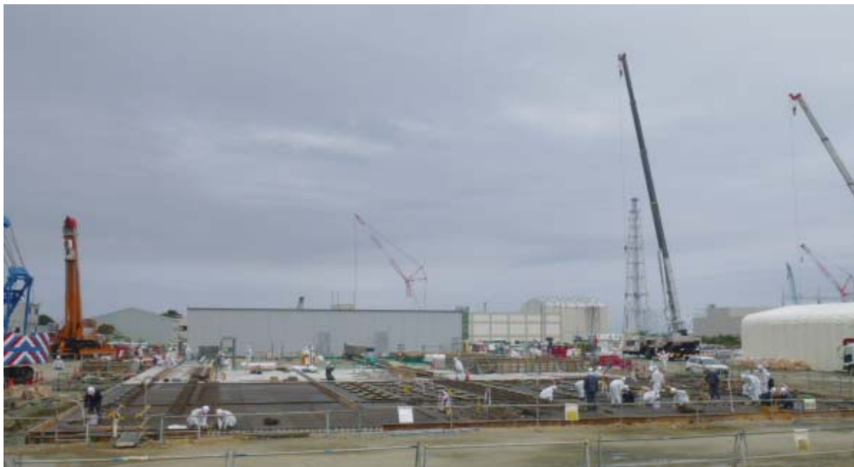
装置設置エリア全景
