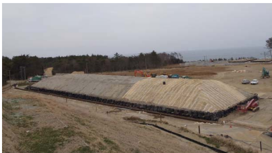
2 槽目の外観 (H25/3/25)
