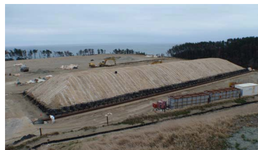
1 槽目の外観 (H25/3/27)
