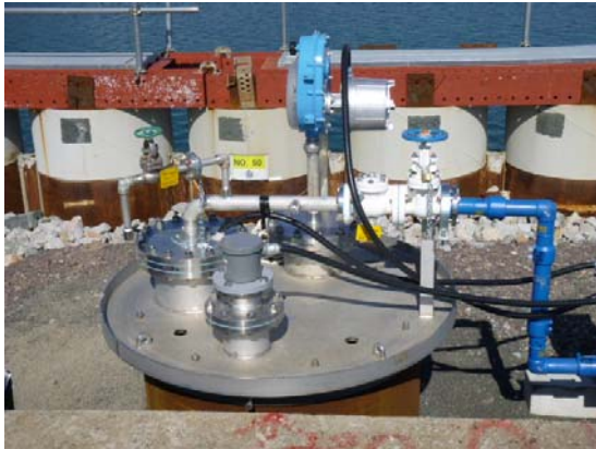
地下水ドレンポンド（A）
