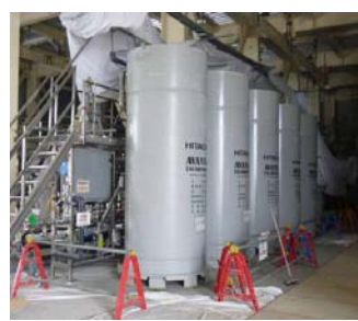
浄化設備 (吸着塔)
