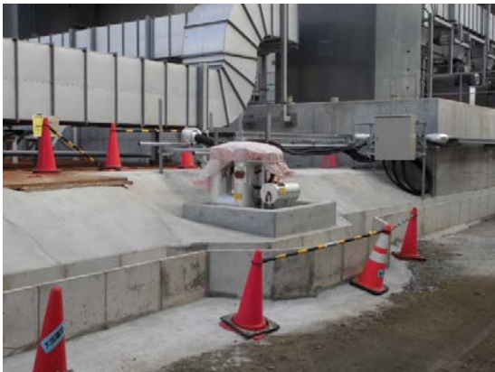
N15サブドレンピット
