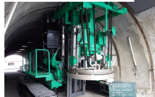
廃棄体を回収するための緩衝材除去装置
