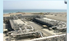
海水淡水化プラント
