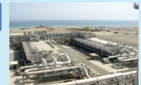
海水淡水化プラント
