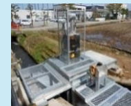
小水力発電施設
