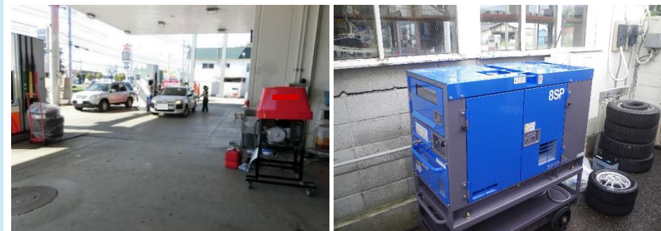
平成30年北海道胆振東部地震や令和元年台風第15号の際に自家発電設備を稼働させて給油を続けたSS
