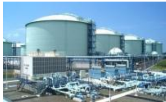
＜福島基地（長崎県）（LPガス）＞
