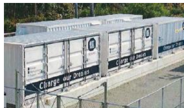
定置用蓄電システム例
