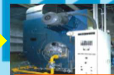
既設ボイラー
