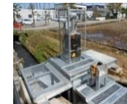
小水力発電施設
