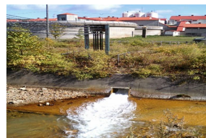
中和処理を行う坑廃水処理施設における省エネルギー設備改修等を実施
