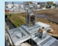
小水力発電施設
