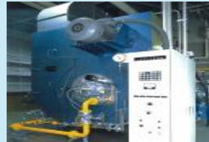
〈高性能ボイラー〉
