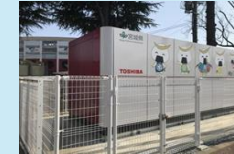
次世代エネルギー設備 （水素利活用等）
