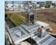
小水力発電施設
