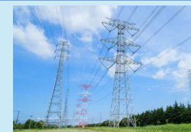
送配電・需給管理
