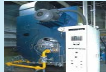
〈高性能ボイラー〉
