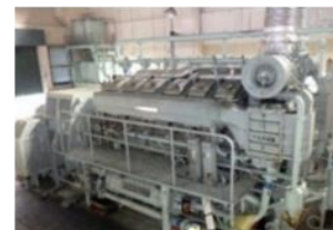
例：自家発電機の整備
