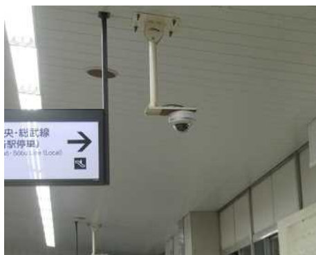
図 3-24 CCTV(全方位対応型)
