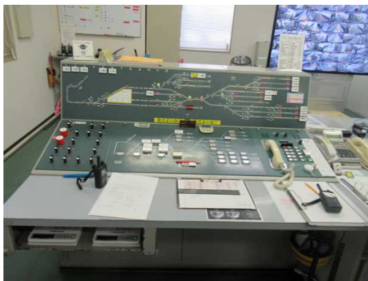
図 3-28 車両基地連動制御盤
