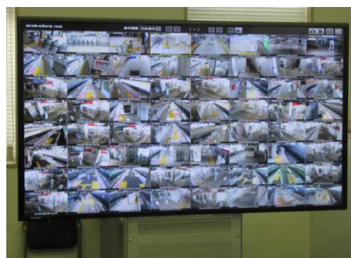
図 3-25 CCTV 監視装置
