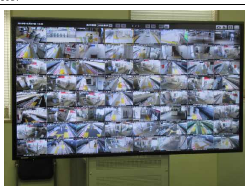
Figura 3-25 Dispositivo de vigilancia CCTV
