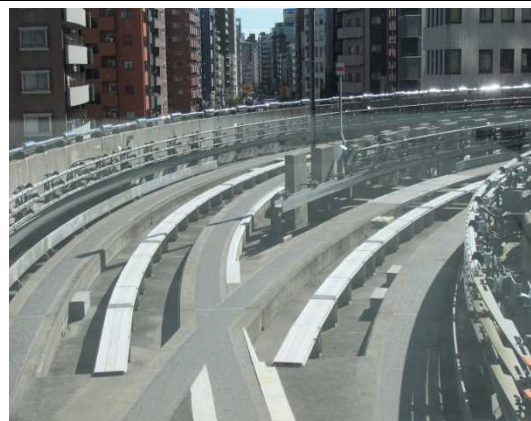
Figura 3-21 Instalaciones de línea eléctrica de la parte de desvío
