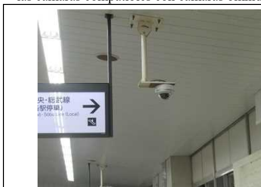
Figura 3-24 CCTV (tipo omnidireccional)
