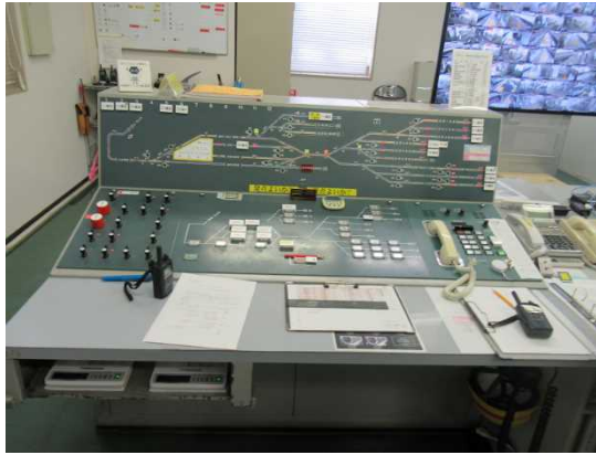
Figura 3-28 Panel de control de enclavamiento de depósito de trenes
