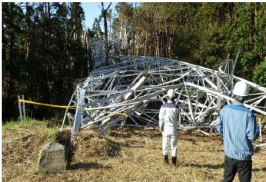
図 3-8 倒壊した鉄塔（No.78） 20
