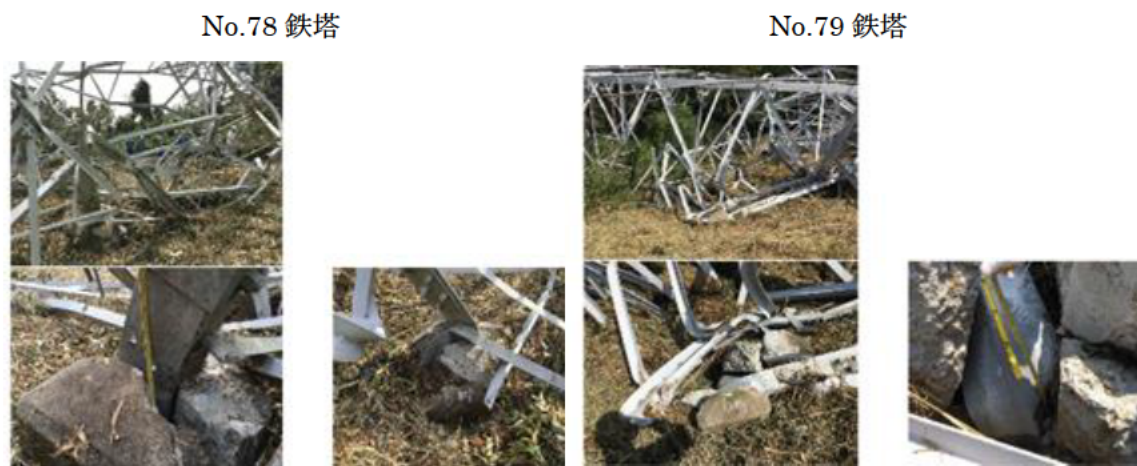
図 3-16 柱体部の損傷状況 20
