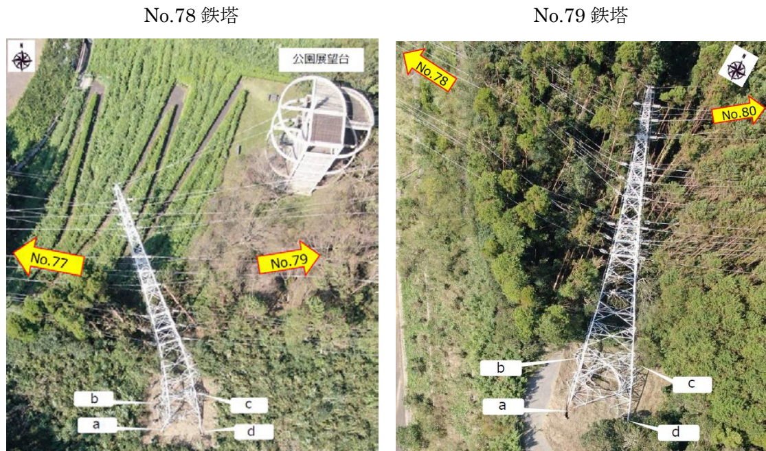
図 3-13 鉄塔の倒壊の様子 20
