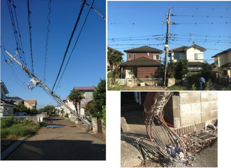
図 3-30 電柱の損壊事故で二次被害が原因と断定できない例
