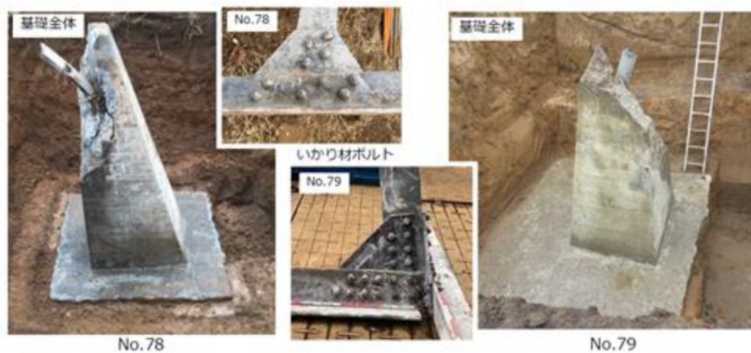
図 3-17 基礎体・地中部の損傷状況 20
