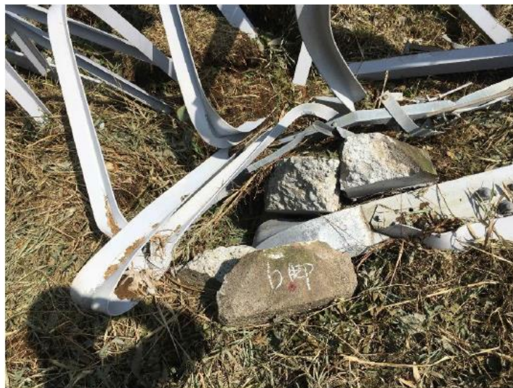
図 3-15 倒壊鉄塔下部の座屈状況 (No.79 鉄塔) 20
