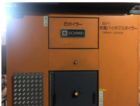
木質バイオマスボイラー
