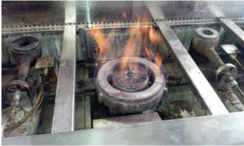
劣化による不完全燃焼
