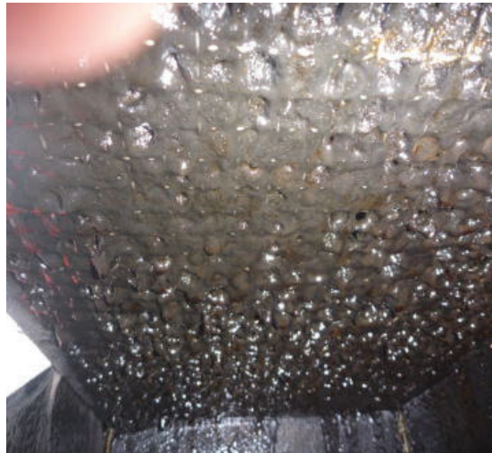
汚れた屋外排気出口
