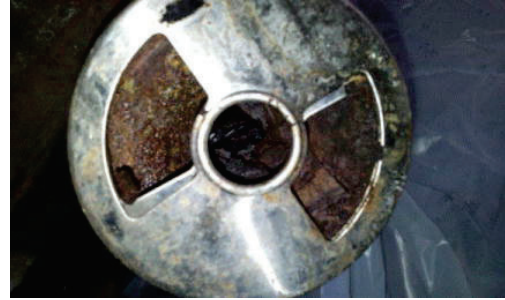
給気口の腐食
