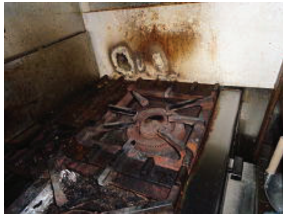
レンジ周りの油に引火した跡
