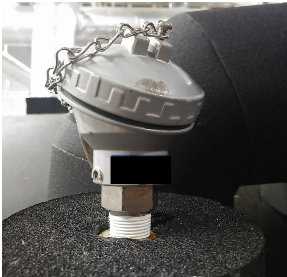
写真 5 低圧の圧力発信器取付け部
