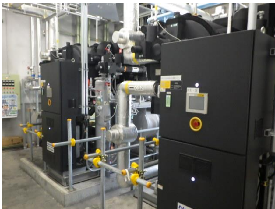
写真1 機械室内の冷凍設備設置状況
