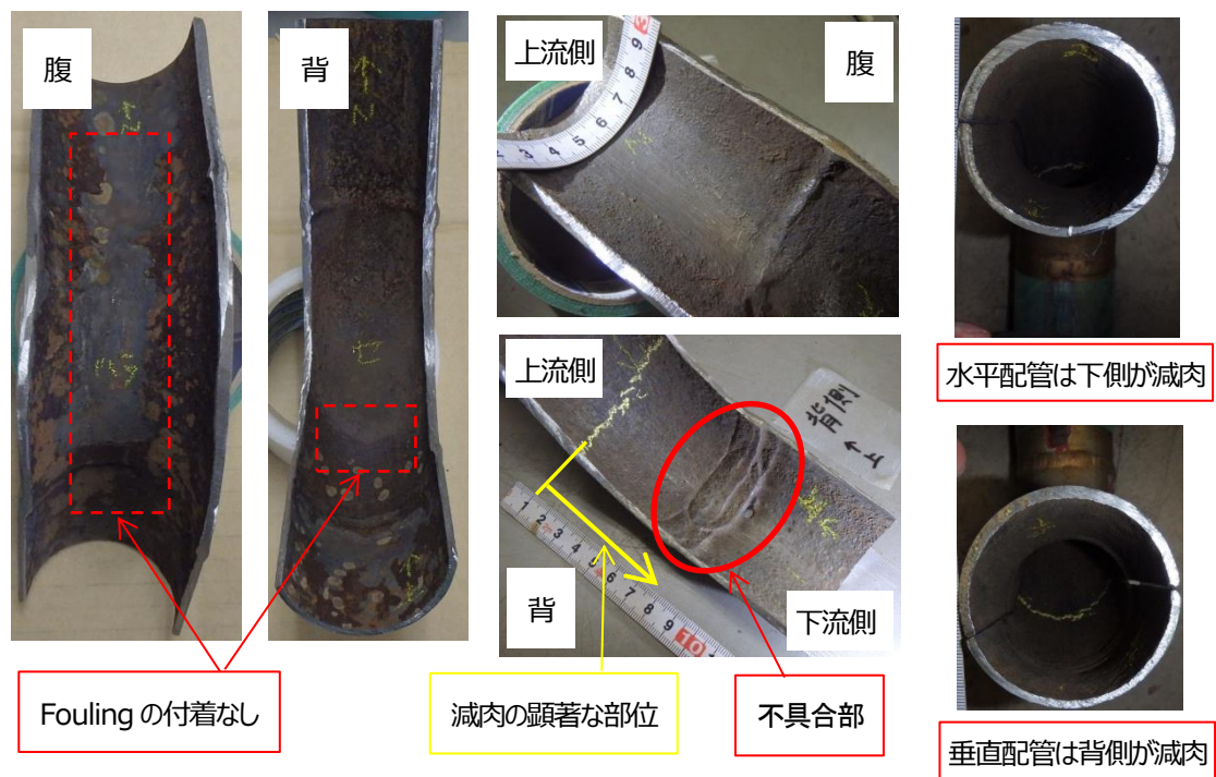
図 2 腐食減肉状況
