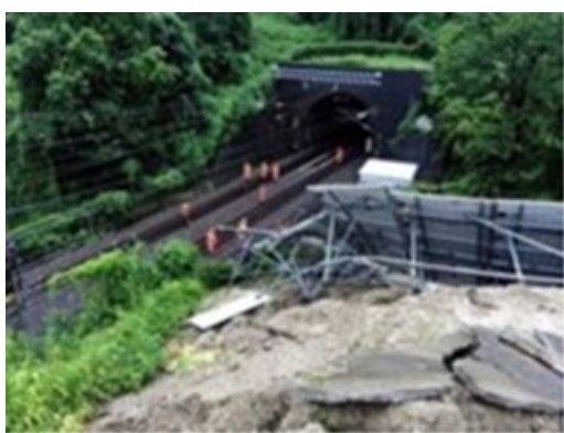
＜小出力太陽電池発電設備の事故事例＞
