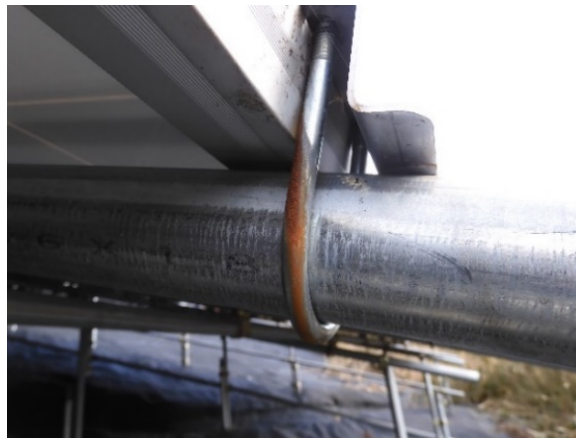
写真 5 U 字型ボルトの著しい腐食（現地調査）
