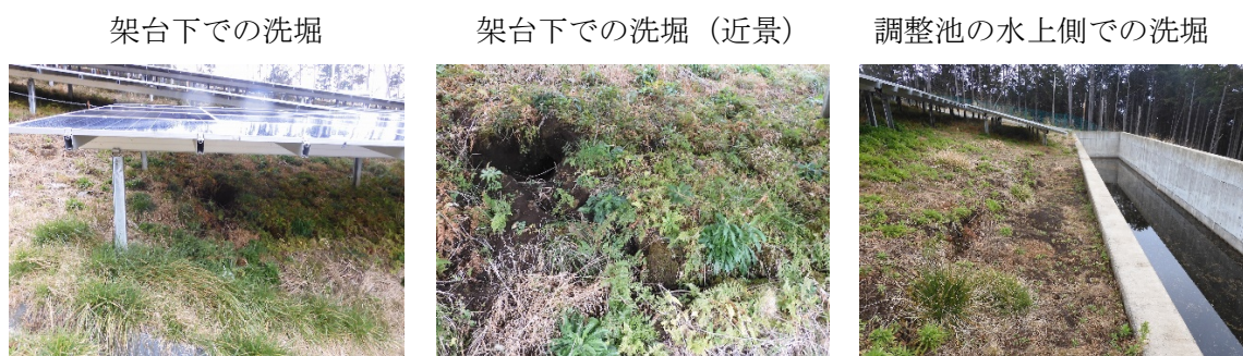
写真 14 地盤洗堀の状況（現地調査）
