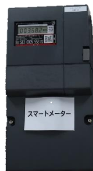
図 2-5 センター内設置スマートメーター
