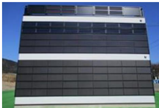
写真 2-2 壁面設置の事例 (NEDO 開発プロジェクトイメージ)
