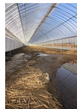
水が引いた後のハウス内
