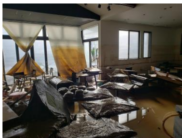
被災後の会議室棟の内部
