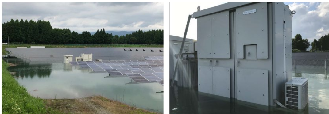
図 II.3.3.17 PCS の浸水した事例
