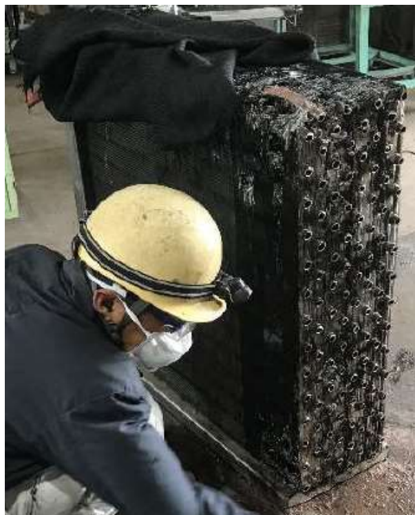
図4 火災後のクーラー外観
