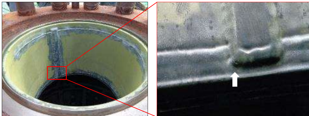
図 2 尿素合成塔における漏えい発生部位(右写真 矢印:貫通部分)
