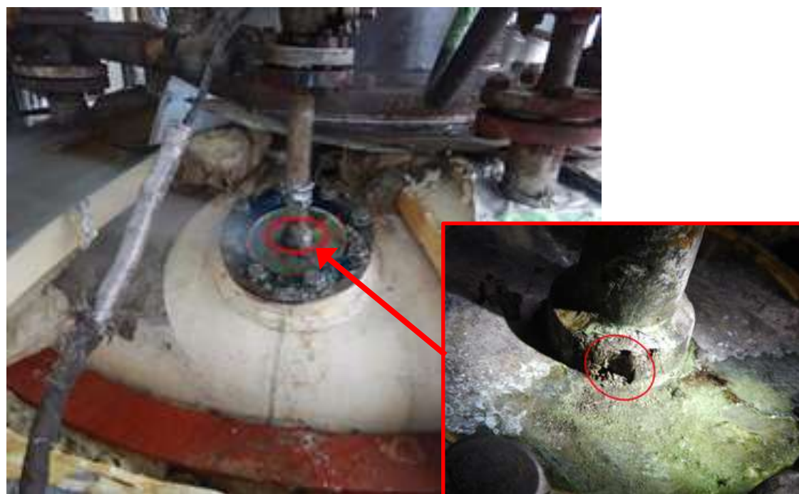
図1 反応槽における漏えい発生部位
