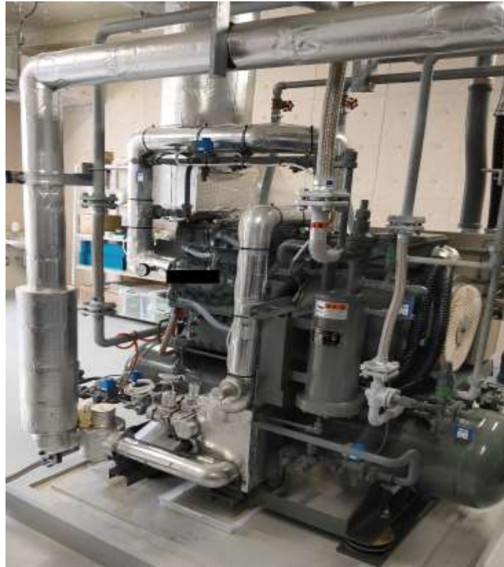
図 1 冷凍設備の全体写真
