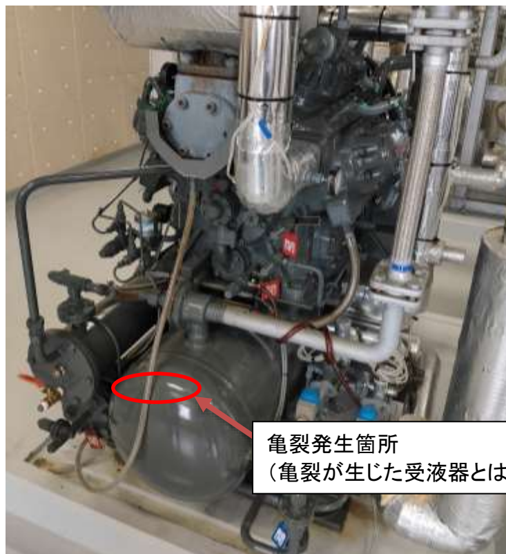
図 2 冷凍設備内の受液器
