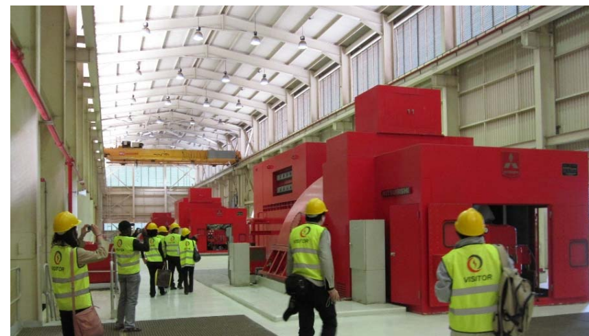
ケニア：三菱パワー製の地熱蒸気タービン・発電機 (140MW)
