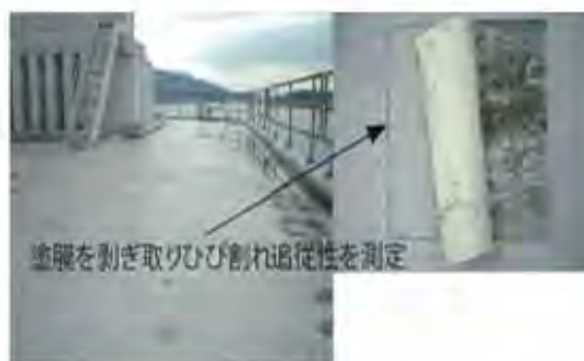
写真-2 17年後のアクリルゴム塗膜状況
