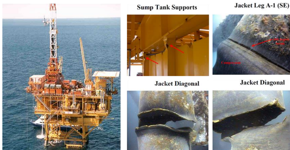
図 3.1-6 原油生産プラットフォーム破損箇所
