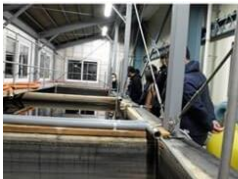
環境大善の生産施設
