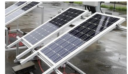
冷却シートを使用した太陽光発電パネル
