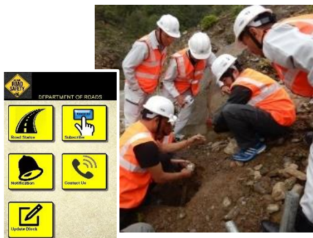
▲事前通行規制のためのモニタリングセンサー設置(右)、スマートホン向け道路情報配信(左)
