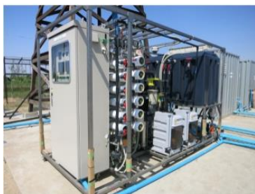
▲ミャンマーに導入した水処理システム
