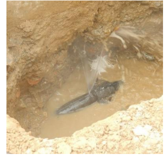
▲特定された漏水箇所
