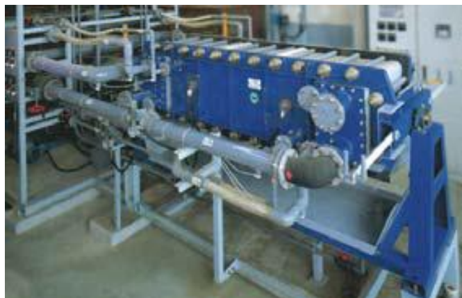
▲電気透析浄化システム
