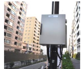
▲冠水警報ユニット
