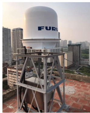
▲設置例（ベトナム）
