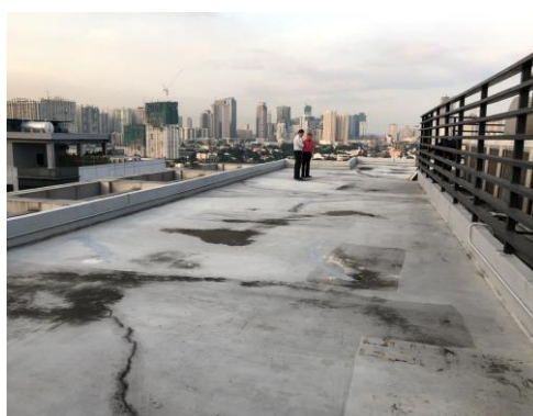
▲建造物の屋上のひび割れ（フィリピン）
