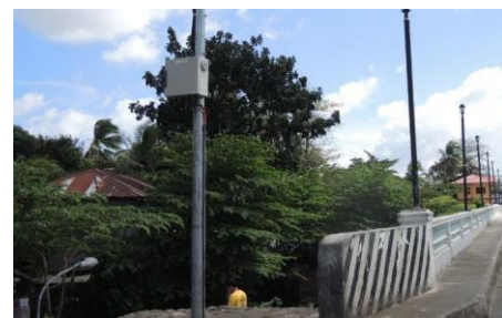
▲設置された警報ユニット（イロイロ市）
