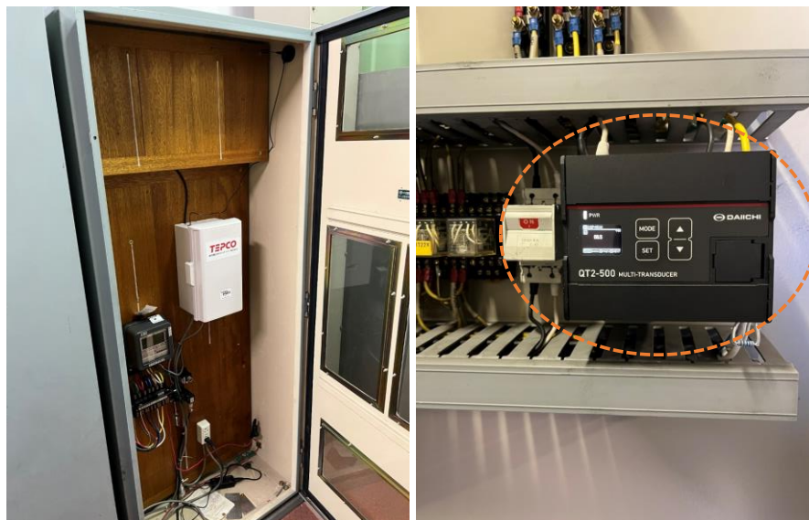
【図 18：川崎サイトへ設置した機器(左：FLEX ボックス/右：トランスデューサー)】
