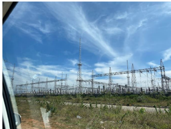
▲周辺に複数ある大規模な変電設備
