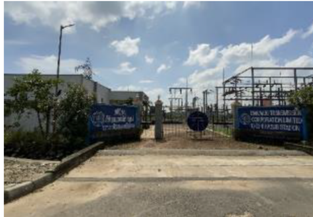
▲TANTRANS CO管理の変電所
