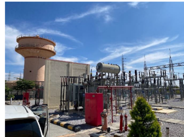
▲TMTPオフィスからの景色 (変電設備と貯水タンク)
