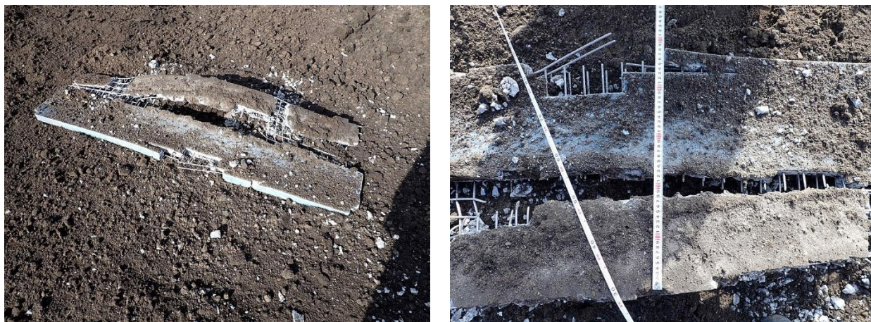
図 4.1.3.1-13 爆発後の擁壁の写真 実験 No.1-3
