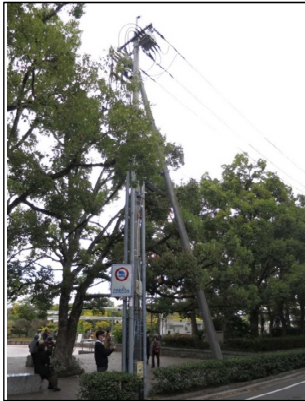
①配電線 (ケーブル立ち上がり)
