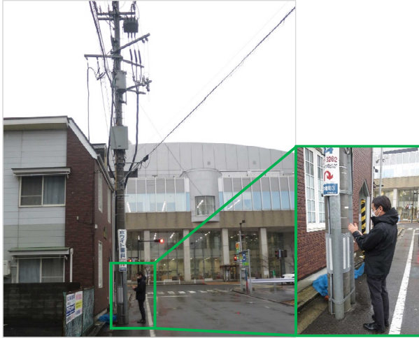
①配電線立ち上り
