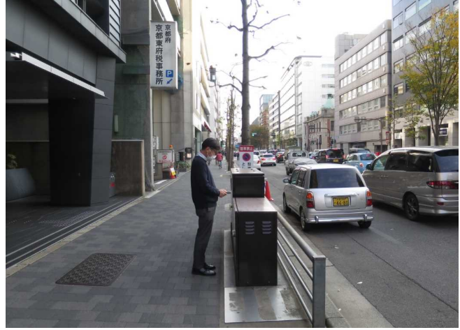
②路上変圧器 (烏丸通歩道)
