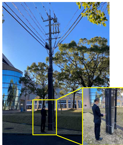
②配電線 (立ち上がり)
