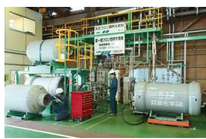
フロン再生設備
