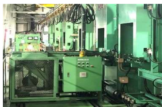
ダイレクト浸炭炉
