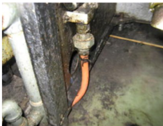
図 2. 2. 2. 4 設置位置の不備
