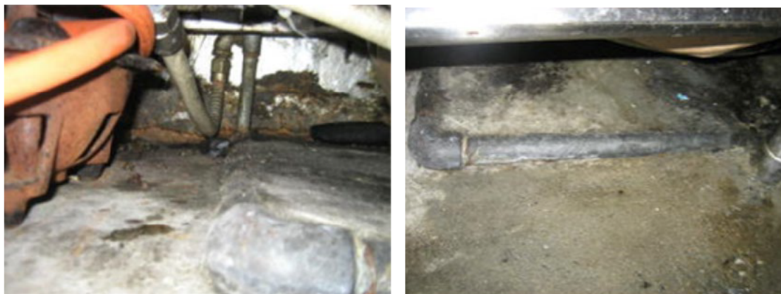
図 2. 2. 2. 3 気付きにくい埋設白管の存在
