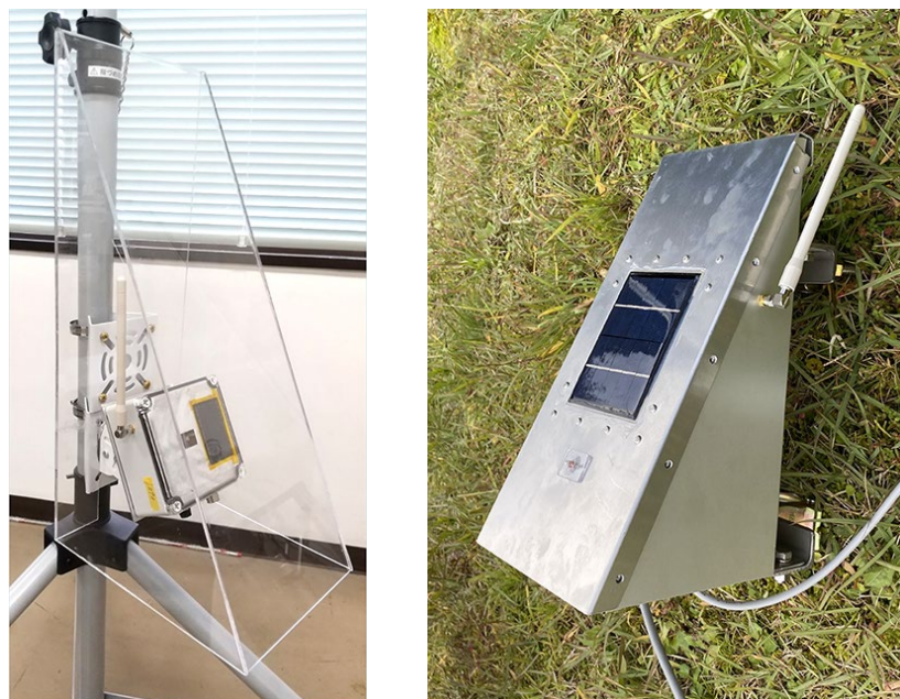
図 3-5 通信ユニットの雪除け対応（左：アクリル板、右：アルミニウム板）
