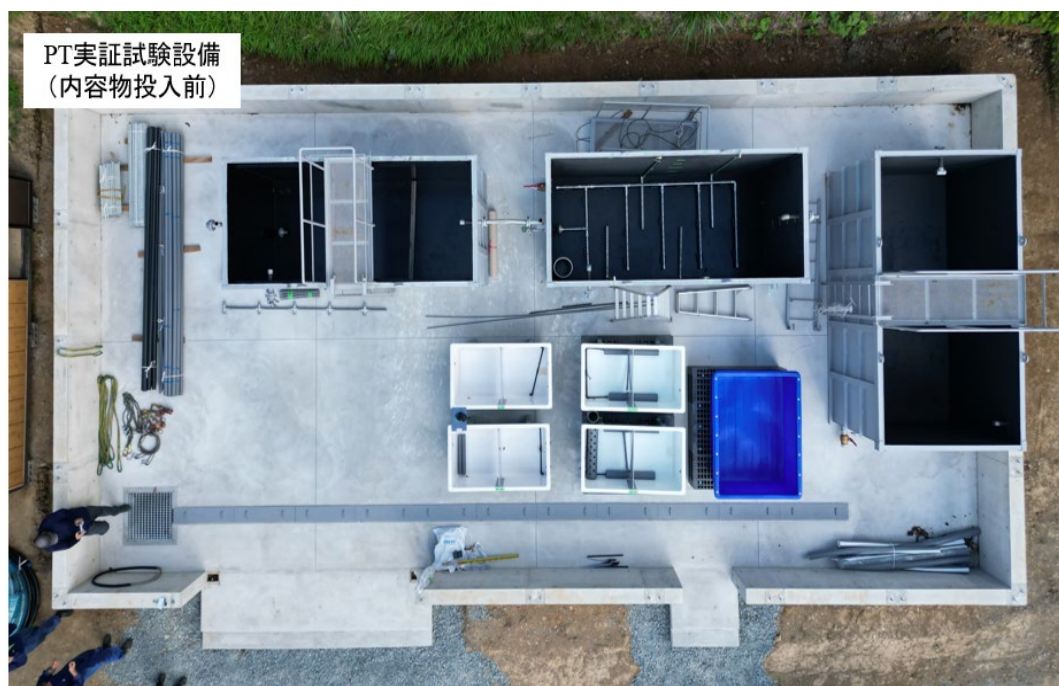
図 2.8-10 PT 実証試験設備設置状況
