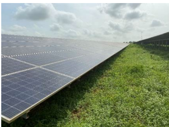
発電所ソーラーパネル
