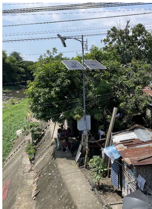
図 3.22 CCTV 河川監視カメラ
