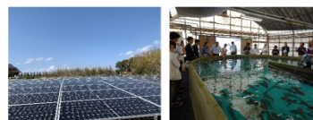
▲陸上養殖場に隣接した太陽光発電設備 ／出所：壱岐市
