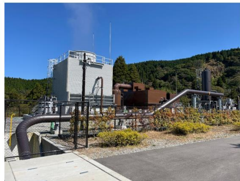
▲南阿蘇湯の谷地熱発電所
