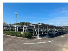
▶ 駐車場を活用した太陽光パネル
