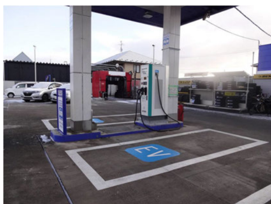
EV 用急速充電設備の施設例 （ガソリンスタンド）
