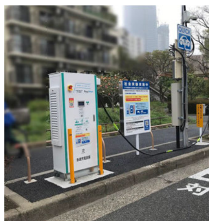
EV 用急速充電設備の施設例（公道設置）
